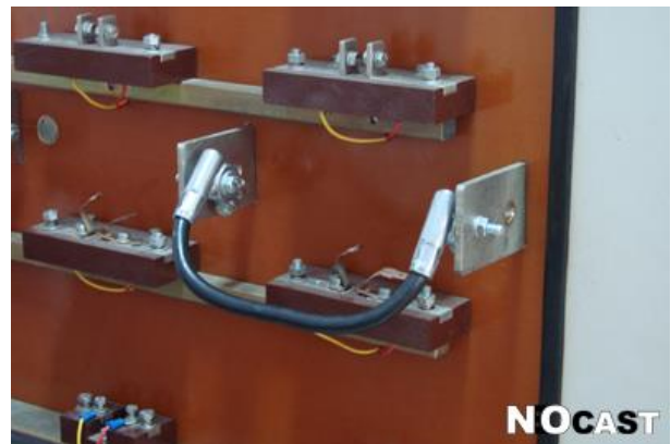
Rys. 5. Widok mostka akumulatorowego w uchwycie urządzenia. Obciążenie prądowe 750 A.
